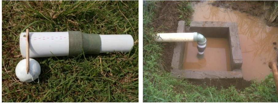
Gambar 1. Komponen kran pelampung hasil desain, dan yang sudah terpasang
